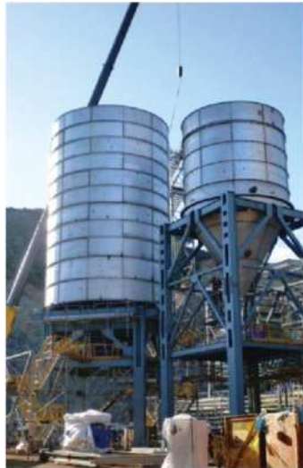
FLY ASH SILO
